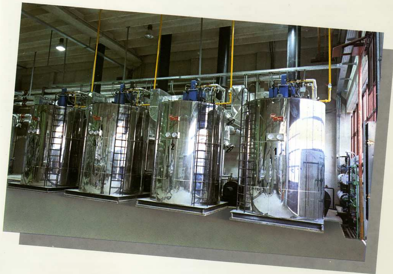
Centrale termica con n. 4 unità da 2.500.000 Kcal./h da noi realizzata presso la FIAT TRATTORI (stabilimento di Jesi - Ancona)
