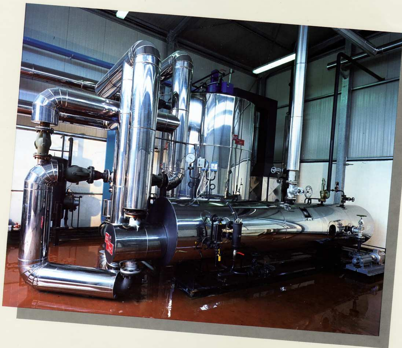
Centrale termica ad olio diatermico per produzione vapore, completamente esente dall'obbligo del fuchista patentato, da noi realizzata presso una industria casearia del gruppo "PARMALAT"
